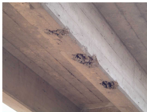
橋梁：コンクリートの剥離
