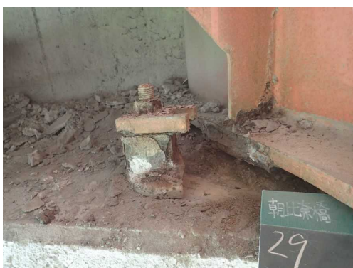
橋梁の鋼製支承破断
