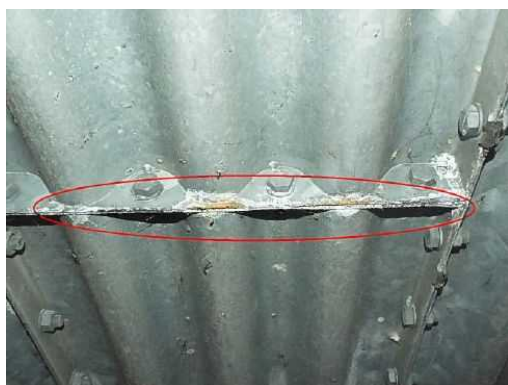
トンネル：覆工補強鋼材の腐食
