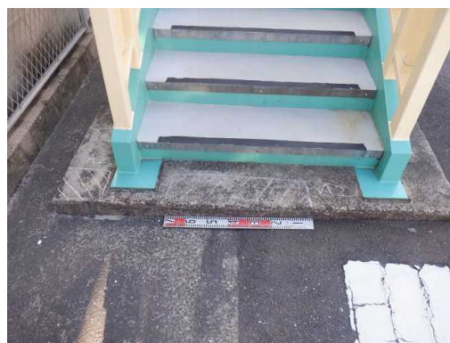
横断歩道橋：橋台のひび割れ・うき
