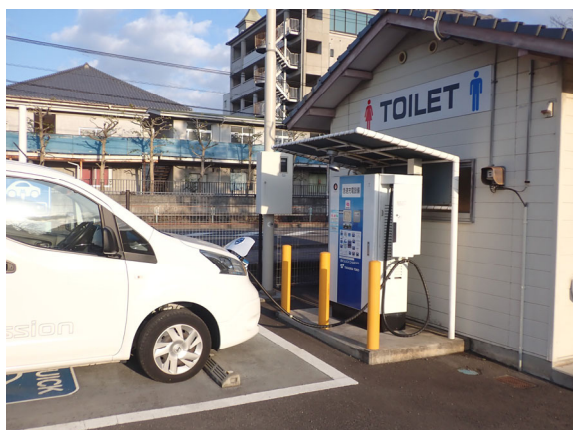
急速充電設備
