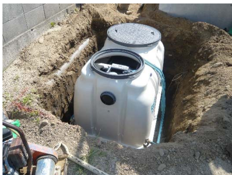
合併処理浄化槽
