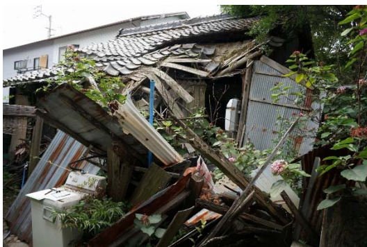
老朽化した空き家
