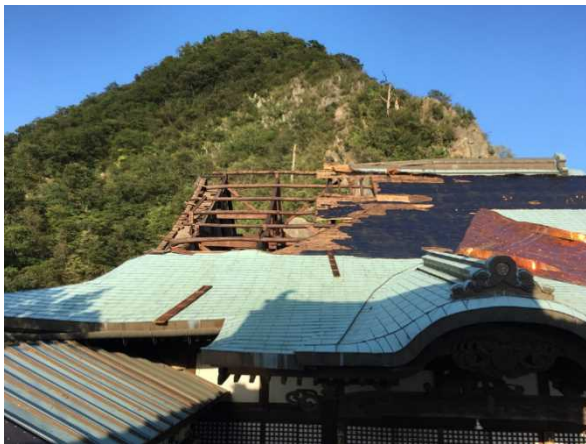
写真) 出釈迦寺奥の院の被災状況
