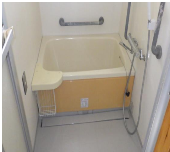
設備の変色・塗装剥がれ
