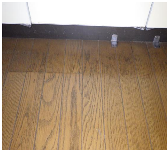
台所床板の汚れ
