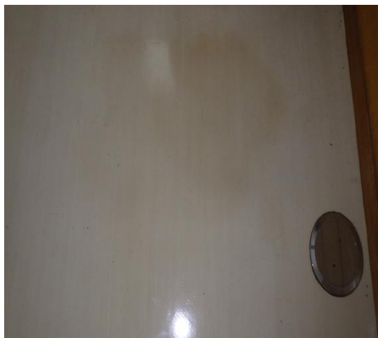
トイレ床面の汚れ
