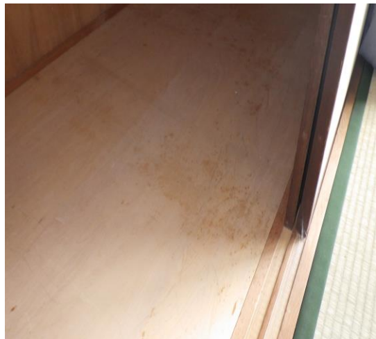
押入床板の汚れ
